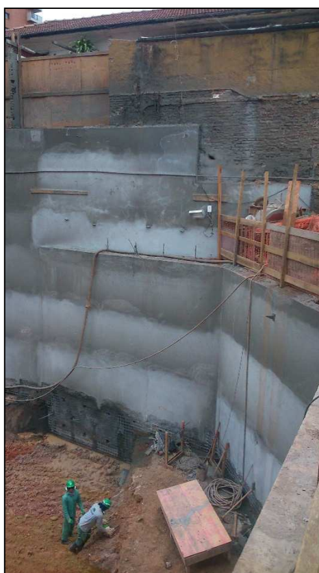
Figura 14.123 - Vista da parede chanfrada na região da frente do terreno (13/08/14).
