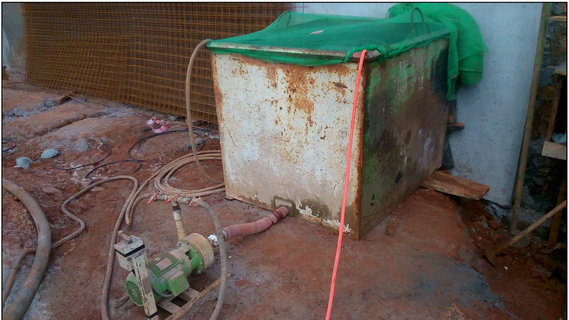
Figura 14.66 - Reservatório de água para a bomba de concreto projetado (11/06/14).
