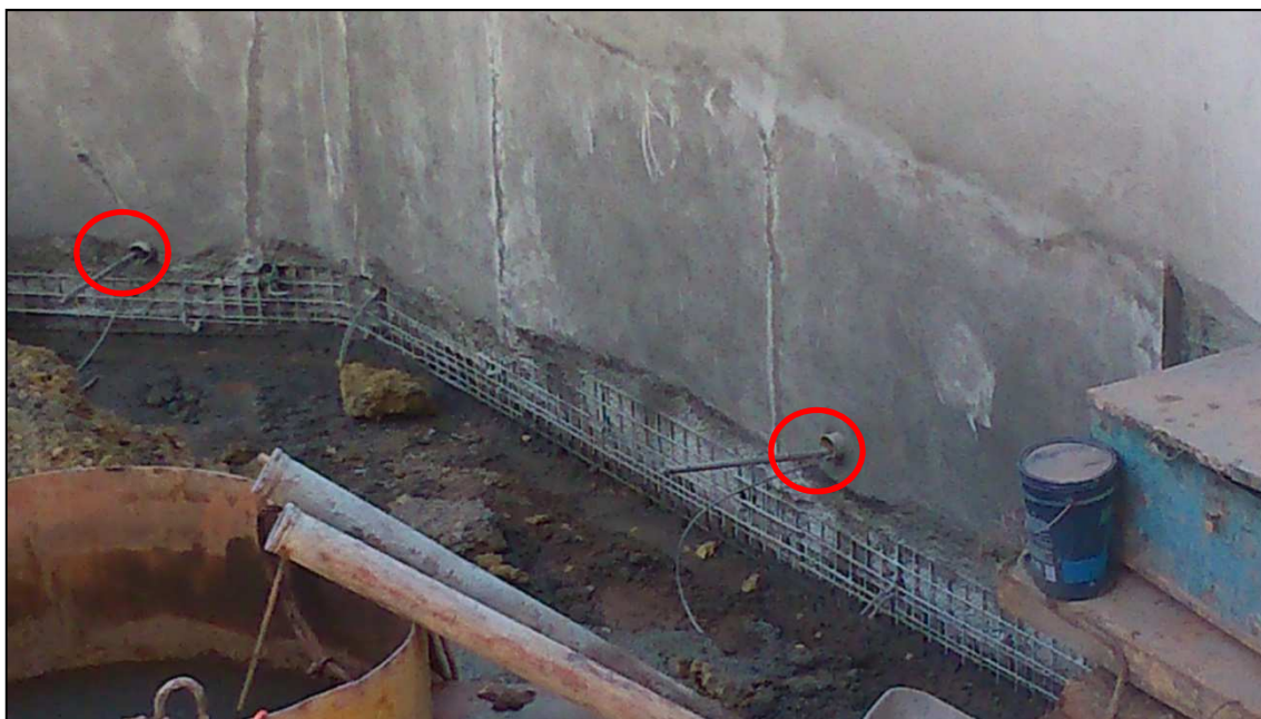
Figura 14.117 - G.5 e G.6 na parede do subsolo na entrada do terreno (06/08/14).
