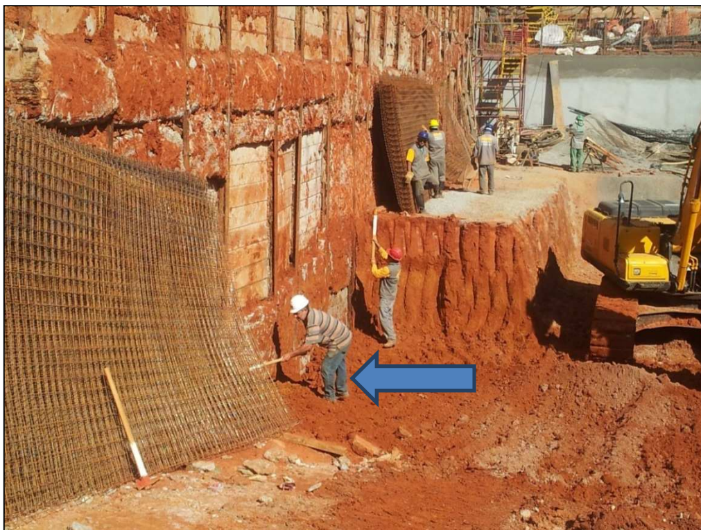
Figura 14.97 - Região onde foram encontrados os blocos de alvenaria (17/07/14).
