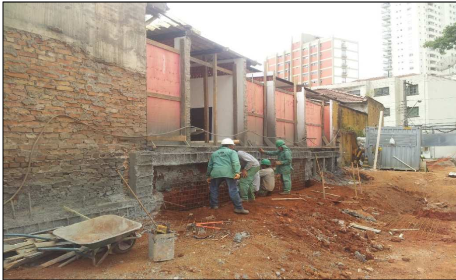
Figura 13.10 - Alteração da viga baldrame
