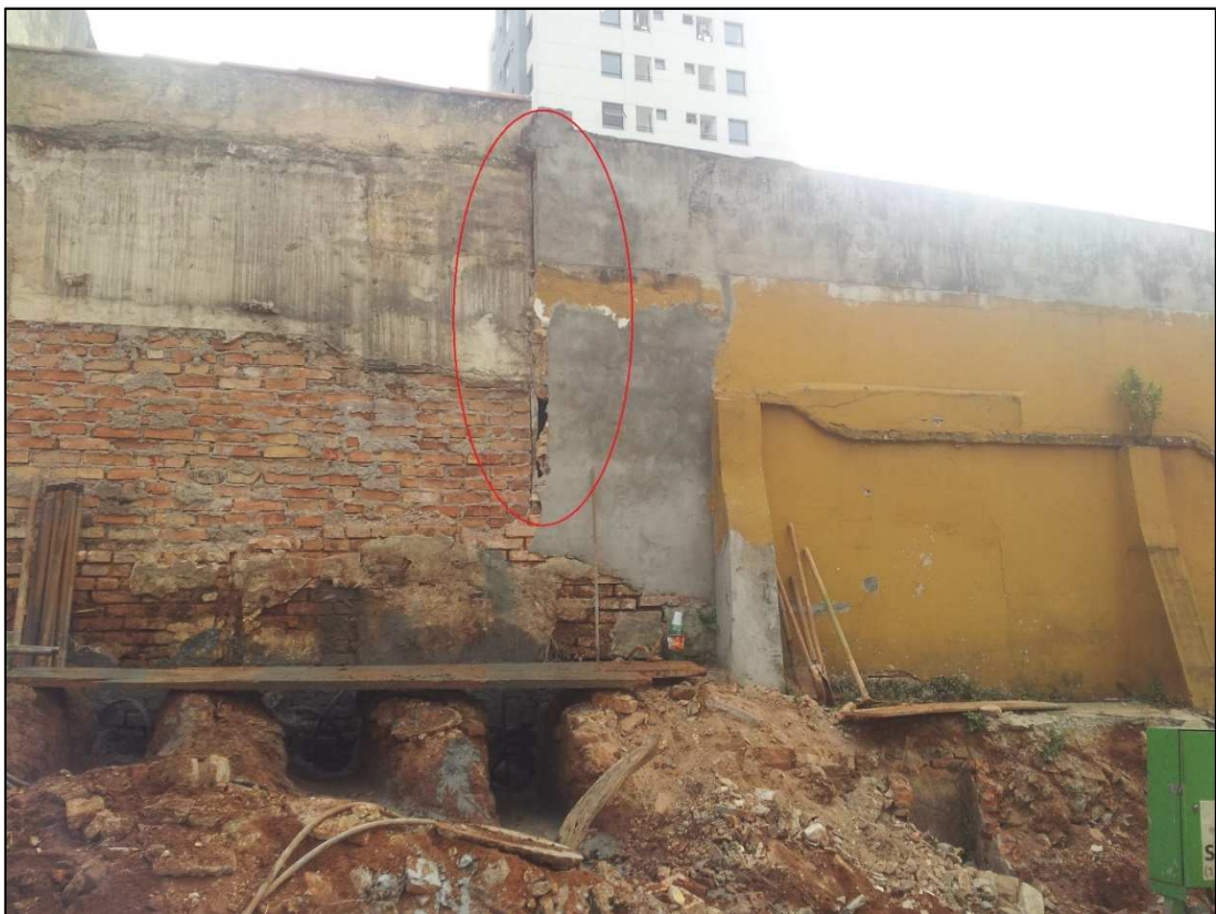
Figura 14.17 - Detalhe 2 da fenda no muro das casas (11/04/14).
